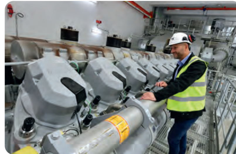
Blick in das Motorenheizkraftwerk Nord.
